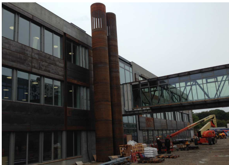
Luftindtag via skorstene for ventilationsanlæg VE01 og VE03 (fra byggefasen)
